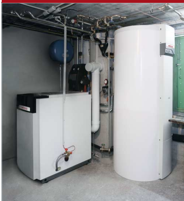
Brennwertkessel STRATON und Wassererwärmer
