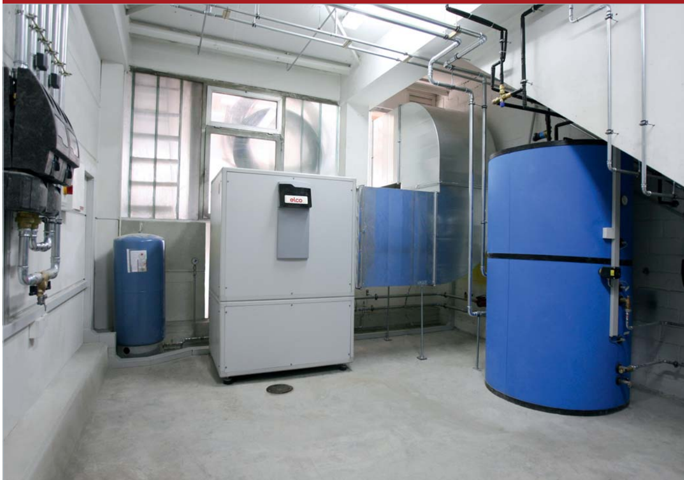
Der Heizungskeller mit (von links) Entladegruppen, Expansionsgefäss, Wärmepumpe, Luftkanal Ausblasseite und Kombispeicher.
